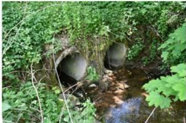
Abschnitt 6: Verrohrung bei Waldwegunterführung. Nicht durchgängig.
